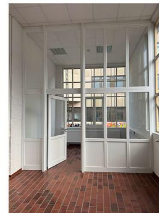
Abb. 10: Glastrennwand im Kesselhaus
